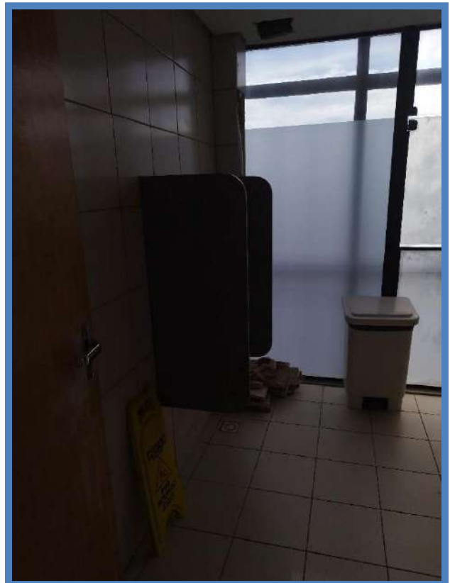
Figura 108: BLOCO A – 2º PAVIMENTO – SANITÁRIO MASC.
