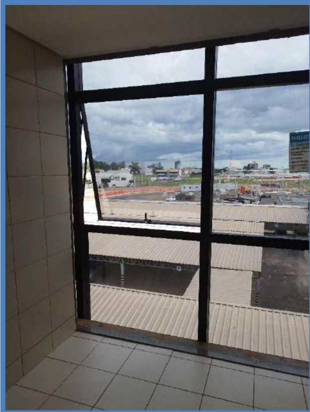
Figura 133: BLOCO A – 2º PAVIMENTO – SANITÁRIO FEM.
