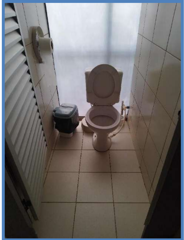
Figura 110: BLOCO A – 2º PAVIMENTO – SANITÁRIO MASC.
