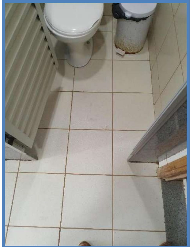
Figura 126: BLOCO A – 2º PAVIMENTO – SANITÁRIO FEM.
