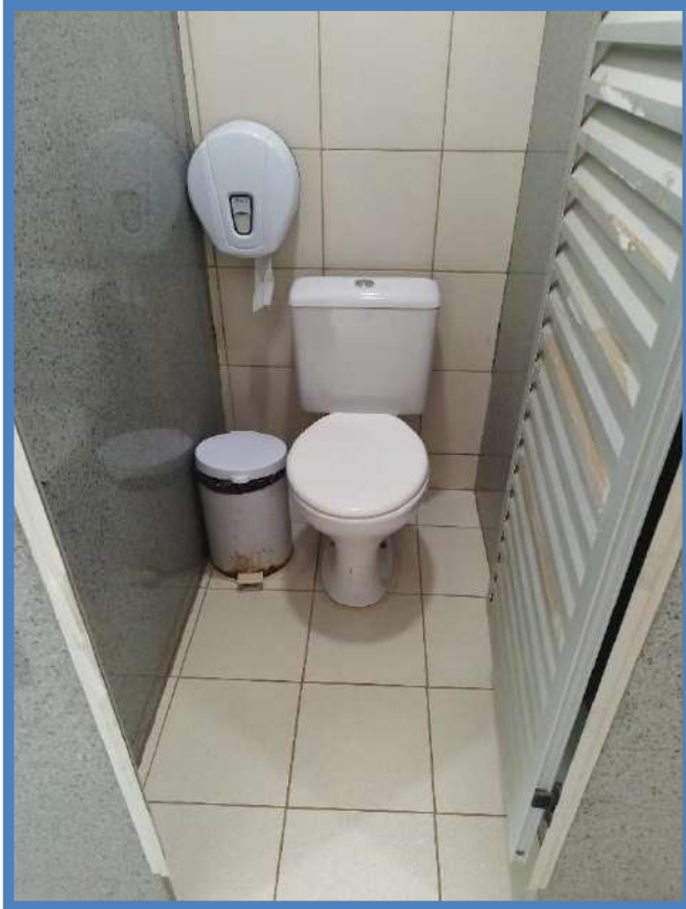
Figura 129: BLOCO A – 2º PAVIMENTO – SANITÁRIO FEM.
