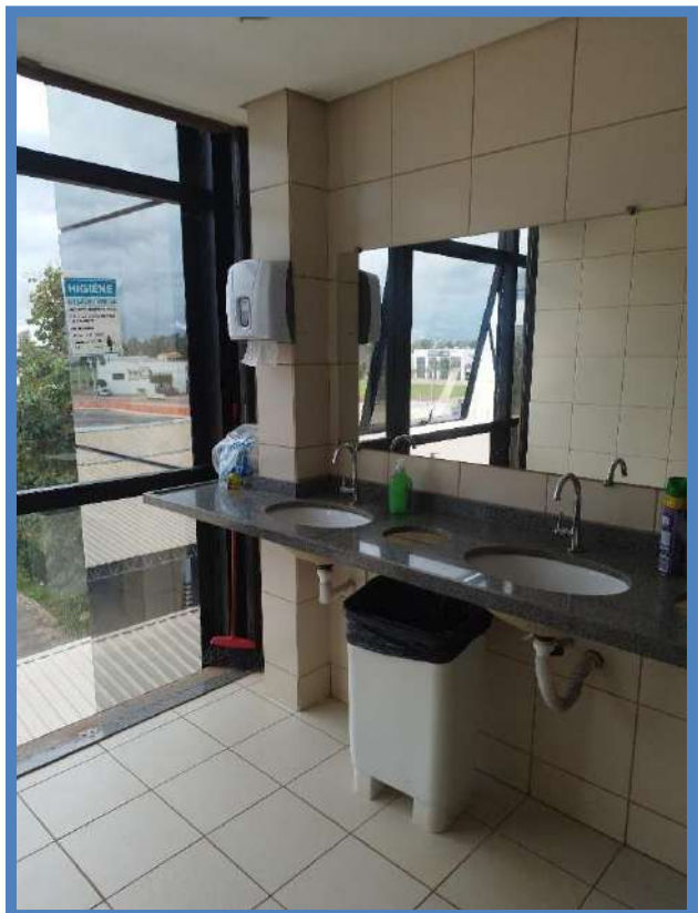
Figura 132: BLOCO A – 2º PAVIMENTO – SANITÁRIO FEM.
