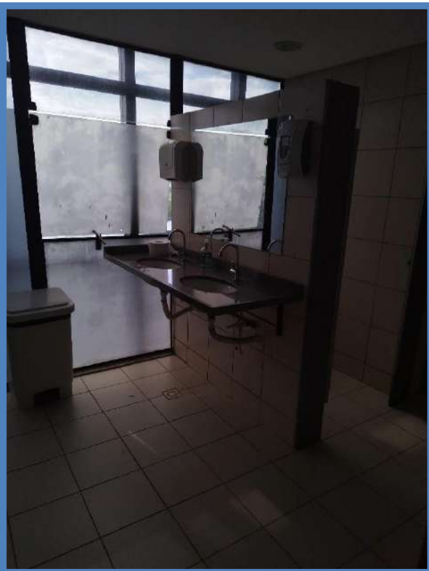
Figura 107: BLOCO A – 2º PAVIMENTO – SANITÁRIO MASC.
