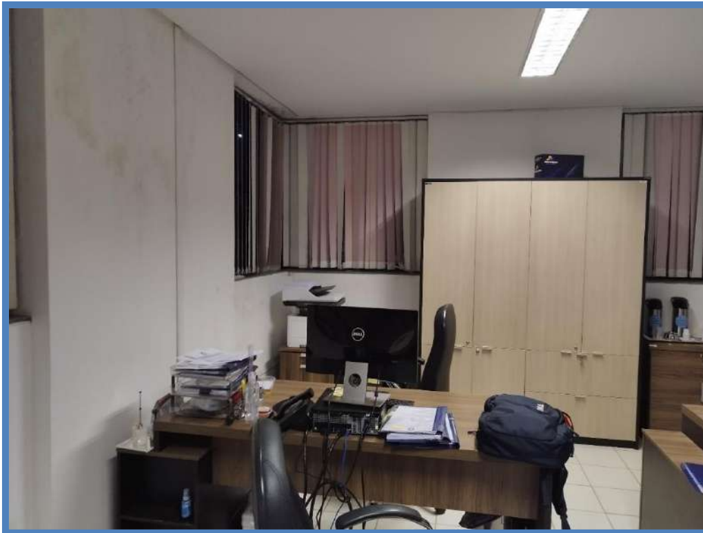
Figura 228: BLOCO B - 1º PAVIMENTO - GABINETE
