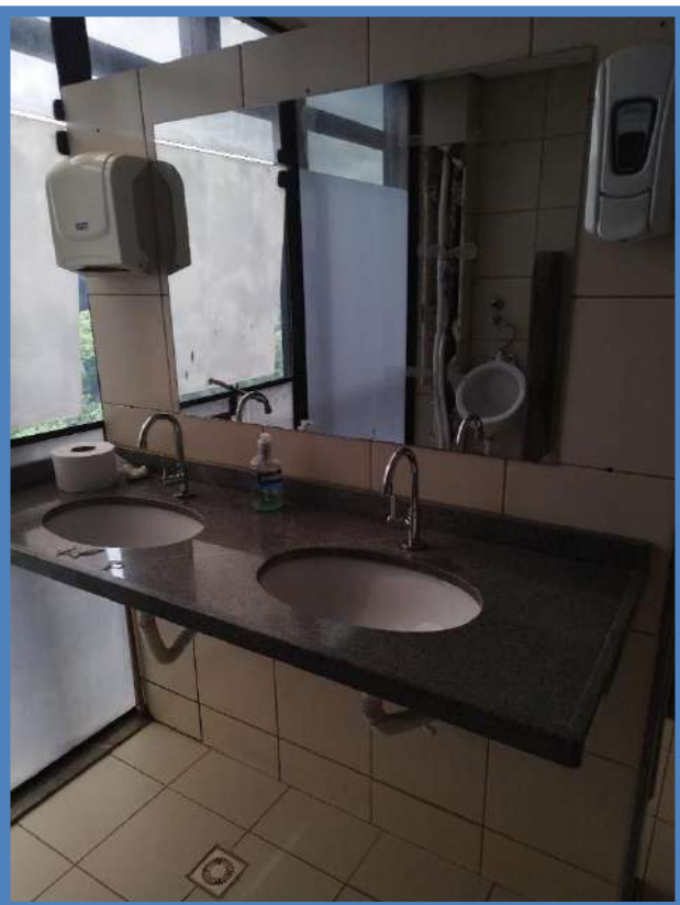
Figura 111: BLOCO A – 2º PAVIMENTO – SANITÁRIO MASC.
