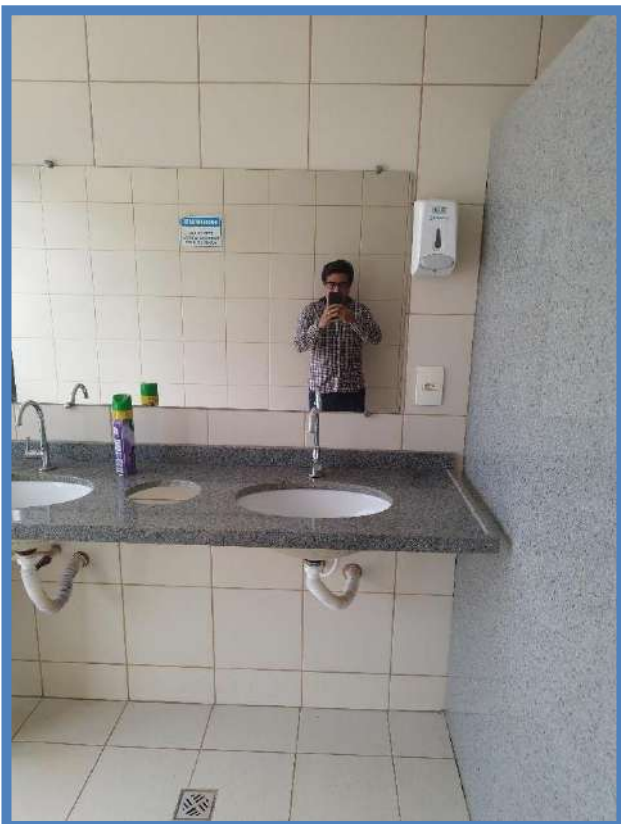
Figura 131: BLOCO A – 2º PAVIMENTO – SANITÁRIO FEM.
