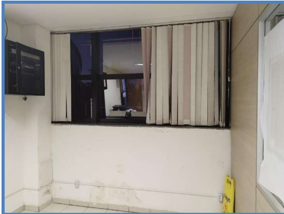
Figura 226: BLOCO B - 1º PAVIMENTO - GABINETE
